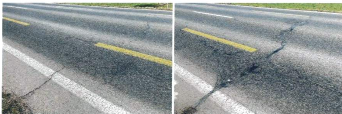
Figure 6 - Etat de la chaussée (fissuration diverse, orniéage et faiçençage)
